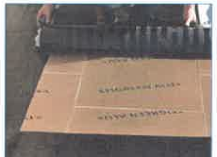
5 Positionner le 2 e suivant et répéter les phases. Recouvrement longitudinal de 6 cm autoadhésif.
